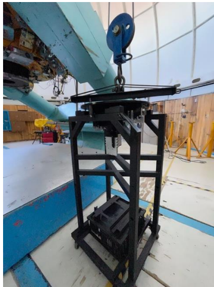
Figura 1.- Vista del instrumento instalado con su carro de transporte en la grúa.
